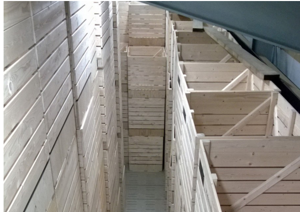
Een vloer met ventilatiekanalen
