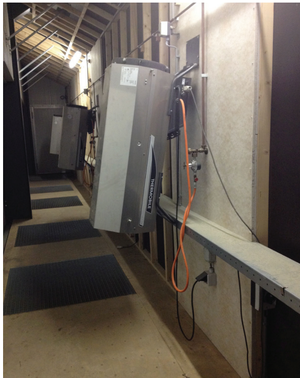
Centrale ventilatiegang met luchtverhitters
