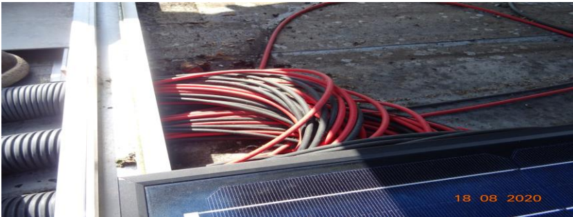
Kabels op het dak Bron: Burghgraef Van Tiel & Partners
