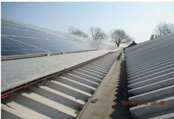
Doorzakken van het dak Bron : Univé
