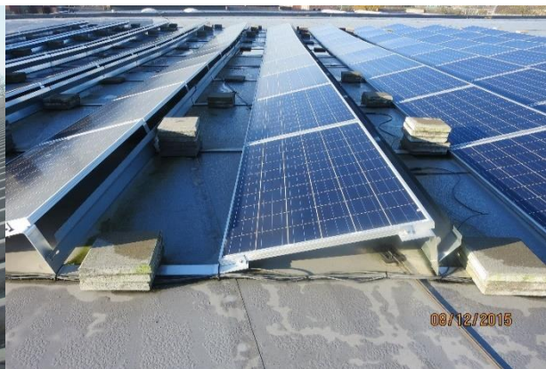
Kabels onder de daklast en water in het midden van het dak Bron: Burghgraef Van Tiel & Partners
